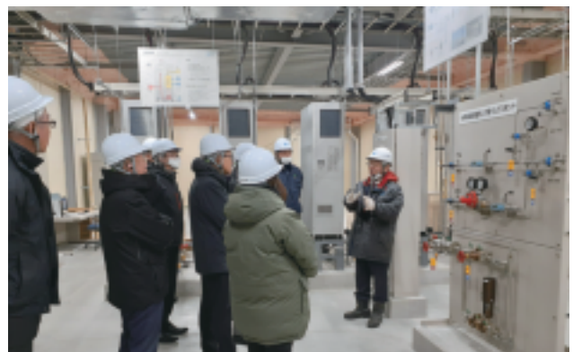
水素発電関連設備（水素棟）
