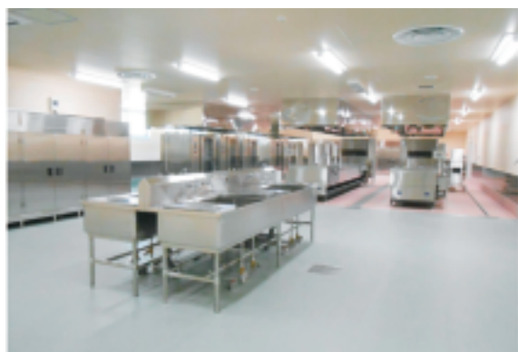
新給食センターの厨房
